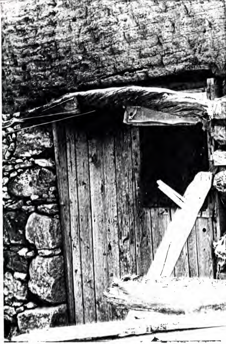
Fotograf No: 132 Ahır kaisının Kuzey-Batı yönünden avludan görünüşü
