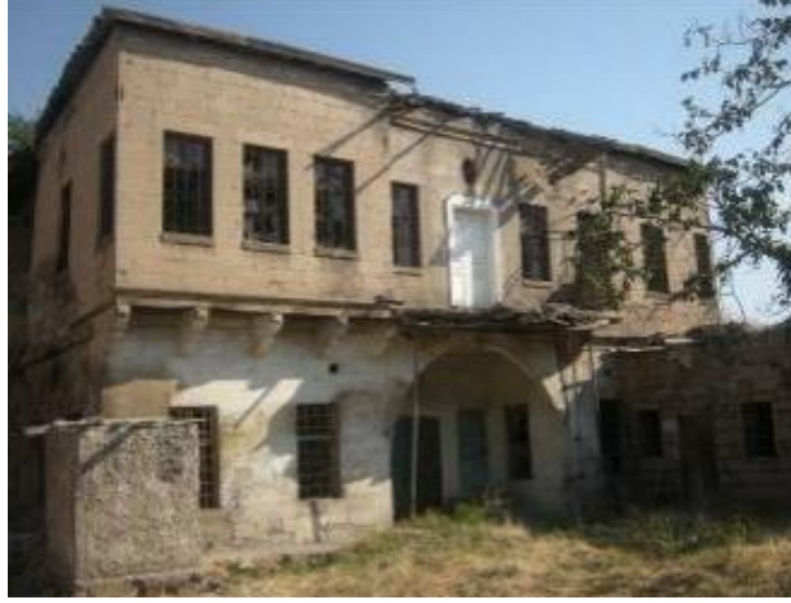
Şekil 5. 81 Aksaray İli'nin Merkez İlçesi'nin Zincirli Mahallesi'nde bulunan Şükrü Aktaş Konağı'nın onarım görmeden önceki hali (Ayçin, F. , ve diğerleri, 2009).
