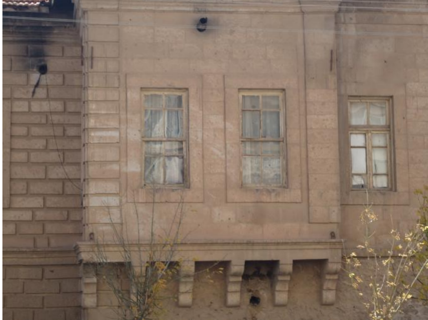
Şekil 5. 132 Çorakçılar Konağı'nın batı cephesinin pencerelerin altında bulunan taşlar (Bediha Uğur).
