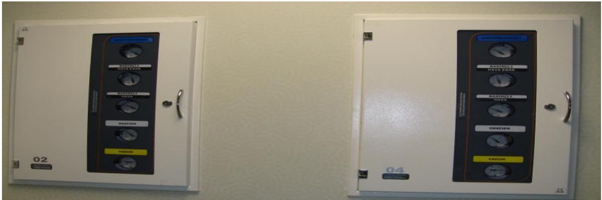
Şekil 6: Merkezî gaz kaynağı alarm sistemi (DİKMEN Yalım, Anestezinin Sırları, 2006)
