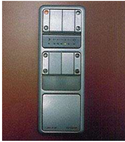
Şekil 2.7: Commerzbank binası kullanıcı kontrol panelleri (Wiggton Harris, 2002).
