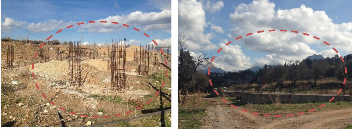
Arazi İçerisinde Temel Aşamasında Atıl Bırakılan Alanlar
