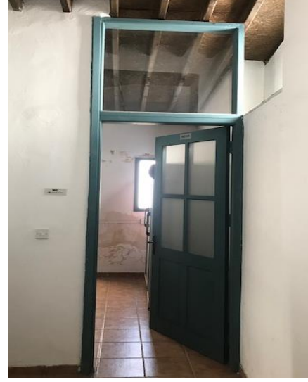
Şekil 4.113: Naci Talat Vakfı Binası mutfak kapısı (Koşanlar, 2018)
