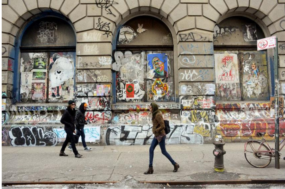
Görüntü 54: Grafitilerle kirlenmiş bir bina örneği. Fotoğraf: Casey Kelbaugh, New York Times https://www.widewalls.ch/is-graffiti-art-or-vandalism/
