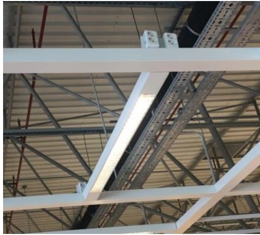
Resim 5.4: TL5 Aydınlatma Örneği
