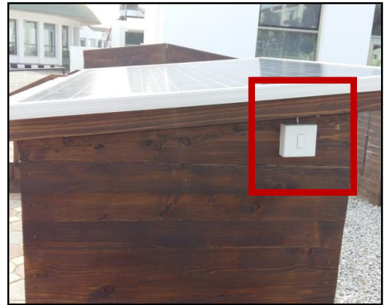
(b) İçerideki aydınlatmayı kontrol etmeye yarayan anahtar
